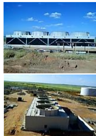
Torre de 4.000m3/h em operação; 17,600GPM cooling tower in operation.
