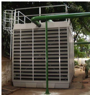
Torre modelo HD-22210-GRT-I em operação; Model HD-22210-GRT-I in operation.
