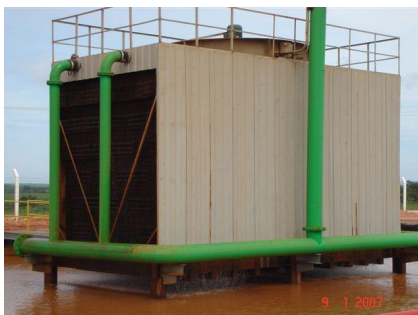
Torre com enchimento tipo grade GRT em operação; GRT type fill cooling tower in operation.
